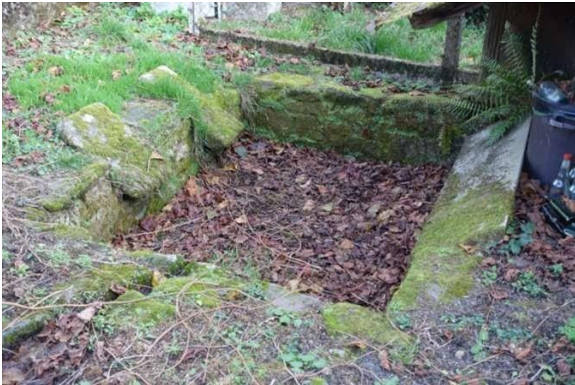
Etat du lavoir avant nettoyage et curage.
